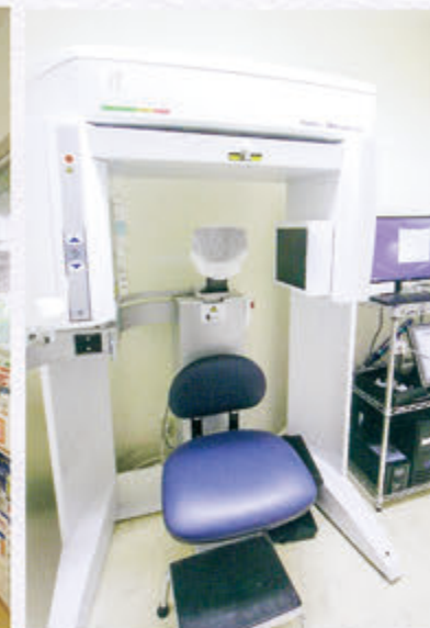
CTを設置したレントゲン室
